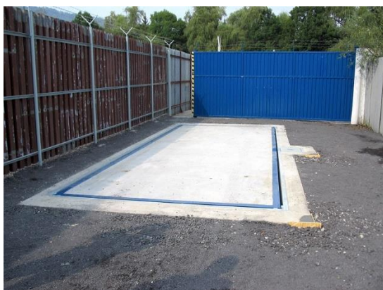
Zapustená mostová cestná váha
