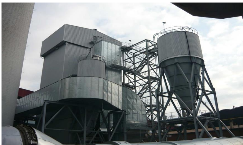
Obr. 95 Odsírovacie zariadenie v areáli Ž. T. a.s.
