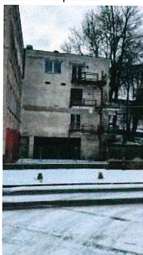
Časť budovy D plynová kotolňa
