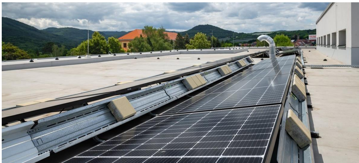
Strešná fotovoltaická elektráreň
