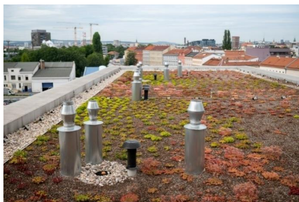
Vegetačná strecha v Brne na ul. Svatopeterská
