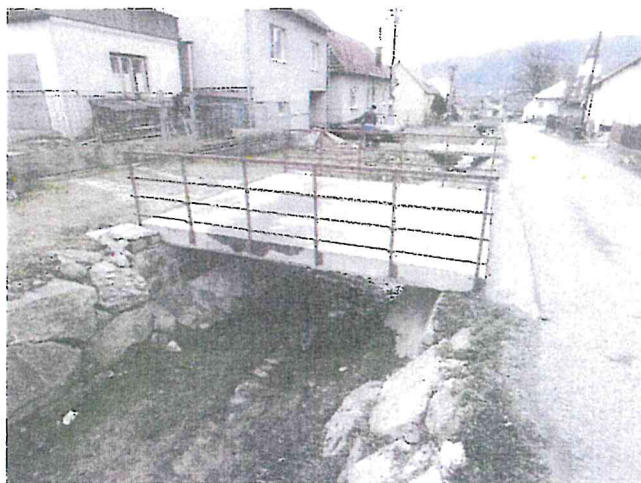
Mostík na p. č. 1189/2 a 1194/3 - celkový pohľad Z z prístupovej - miestnej komunikácie
