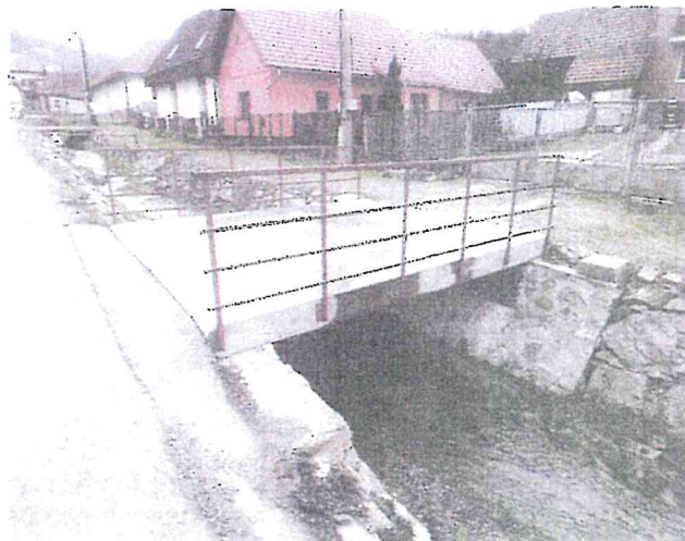
Mostík na p. č. 1189/2 a 1194/3 - celkový pohľad V z prístupovej - miestnej komunikácie
