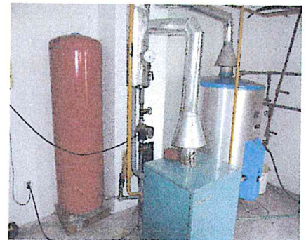
Plynová kotolňa s plynovým zásobníkom na TÚV v budove skladu, soc. zar. a kotolne
