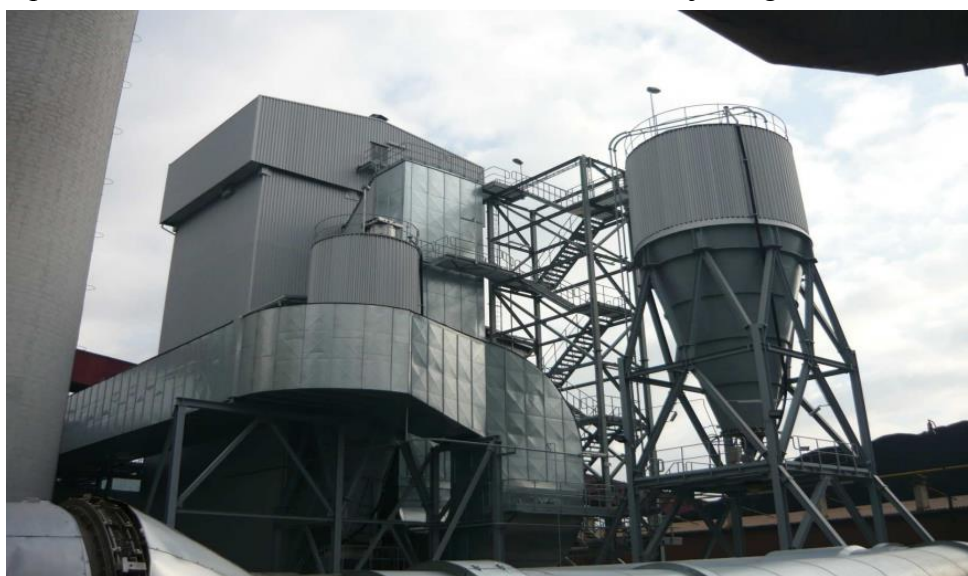
Obr. 95 Odsírovacie zariadenie v areáli Ž. T. a.s.
